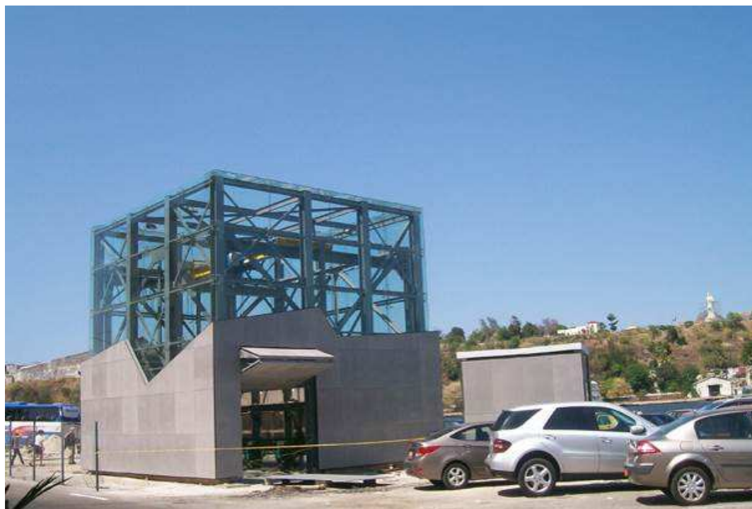
Un dé d'acier de béton et de verre sert d'écrin désormais aux 3 dégrilleurs du SIAAP
